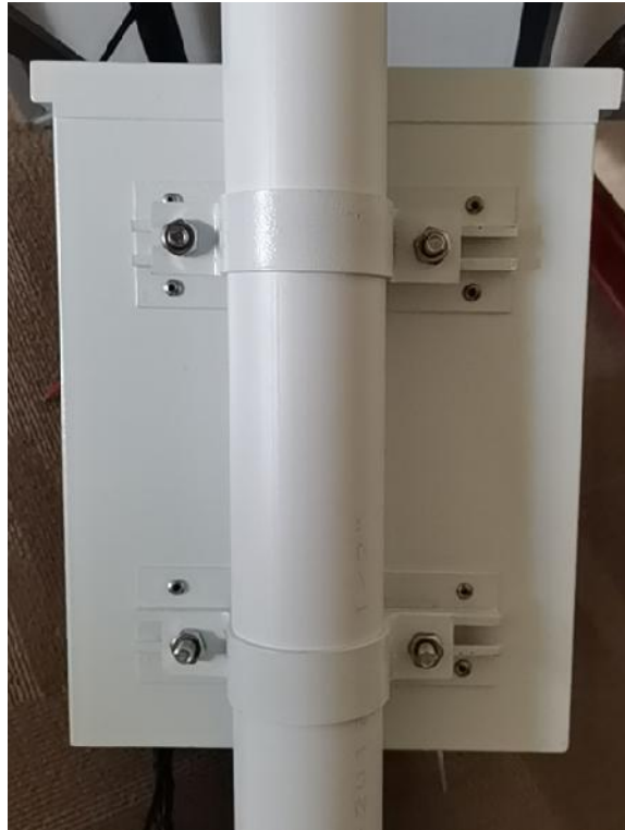
安装完成背面图
